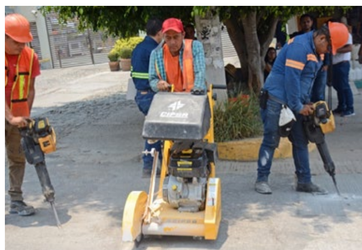
▲ Las obras en Lomas de Ahuatlán servirán para mejorar el servicio de agua potable y evitar fugas y daños al pavimento de la avenida Gustavo Petriccioli. Foto: Especial.
