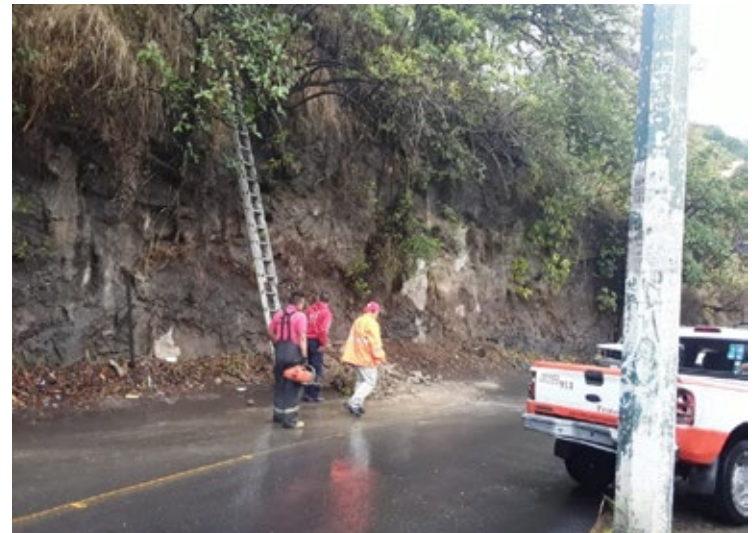
▲ El Ayuntamiento de Cuernavaca informó que los derrumbes en la avenida Chulavista, la colonia Lagunilla y la calle Laurel, no ocasionaron daños mayores. Foto: Ayuntamiento de Cuernavaca.
